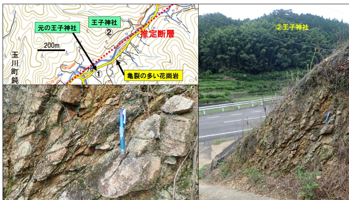
図5-1. 元の王子神社の北東の露頭に見られる亀裂の多い花崗岩。亀裂は道路とほぼ平行な北東-南西方向の走向で、傾斜は北傾斜約45度となっている。こうした亀裂の入り方と斜面の方向との関係は「流れ盤」の関係であり、斜面は崩壊しやすい状態にあるといえる。亀裂には鱗片状に波打ったような亀裂も見られることから、圧縮場で形成された逆断層の影響で形成された亀裂と考えられる。
